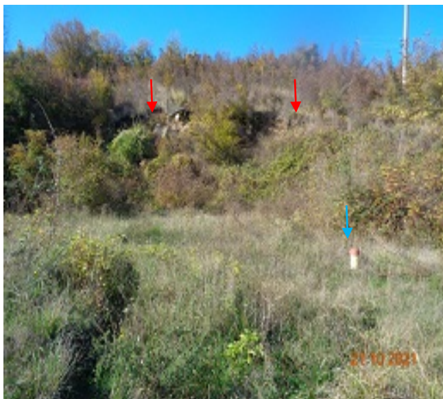
сн.1 - общ изглед на свлачището свлачищен отстъп и пиезометър 1/17
