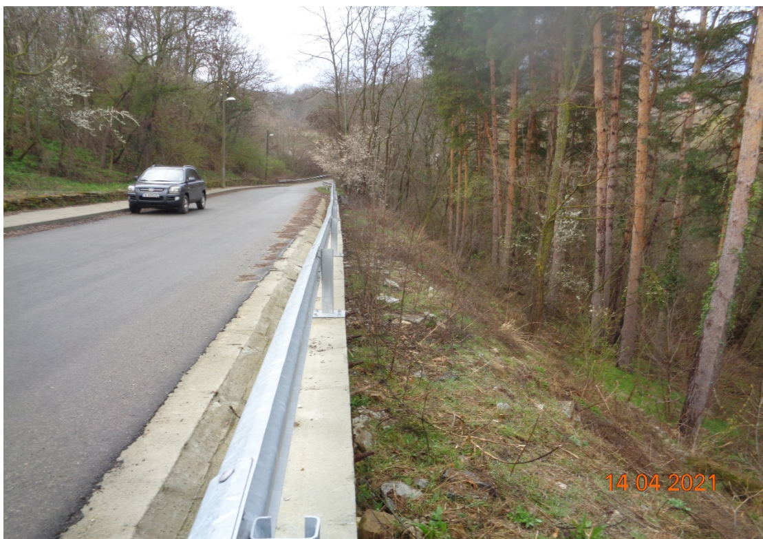
Сн 1. - общ изглед на ул. „З.Стоянов“ с изпълнените укрепителни мероприятия
