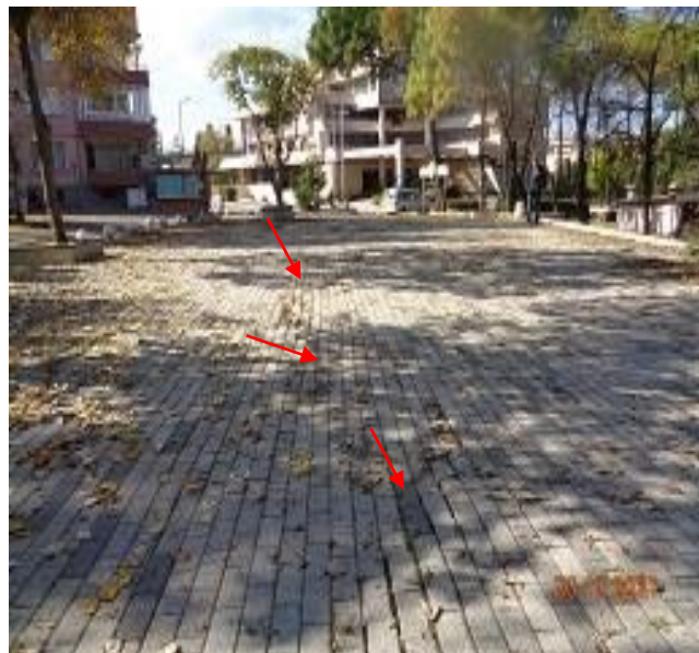
сн.1 20.10.2021 г. – пукнатина и деформирани плочки по нея
