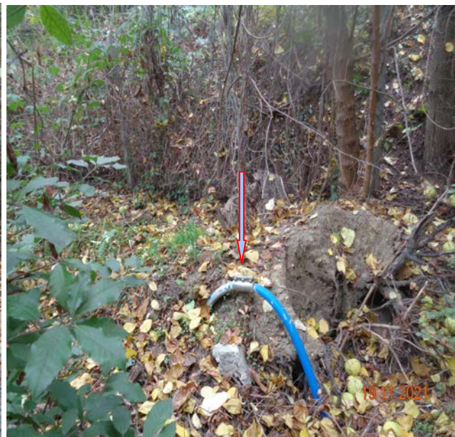
Аварията на ВиК провода е отстранена
