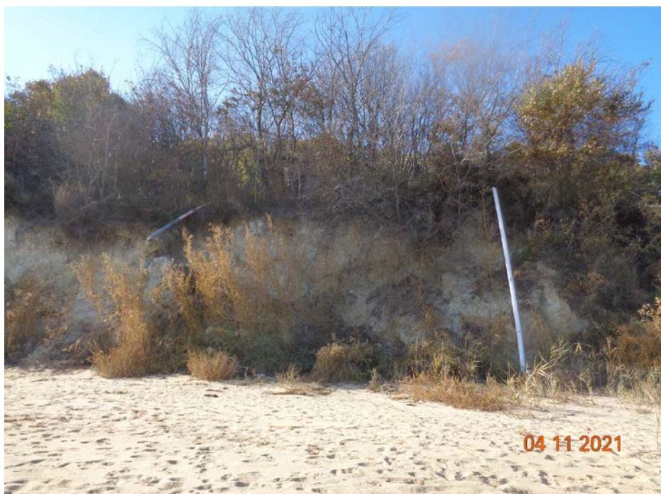
Сн.8. PVC проводи, стърчащи по клифа
