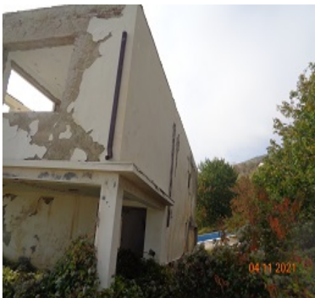
сн.3. – разрушена сграда в УПИ XXI-98
