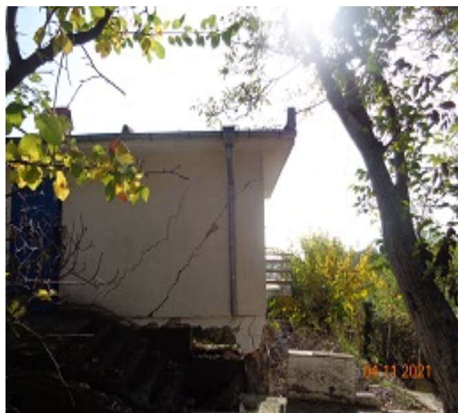
сн.4. – разрушена сграда в ПИ XVII-108
