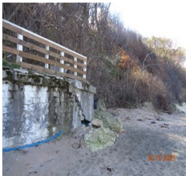
сн.2 – деформации в края на стълбищната площадка
