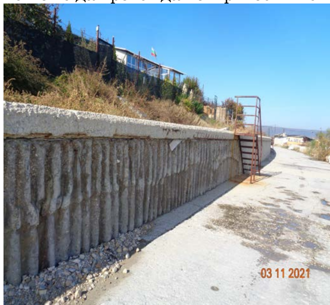
сн.6. участък на подпорната стена с оголена армировка
