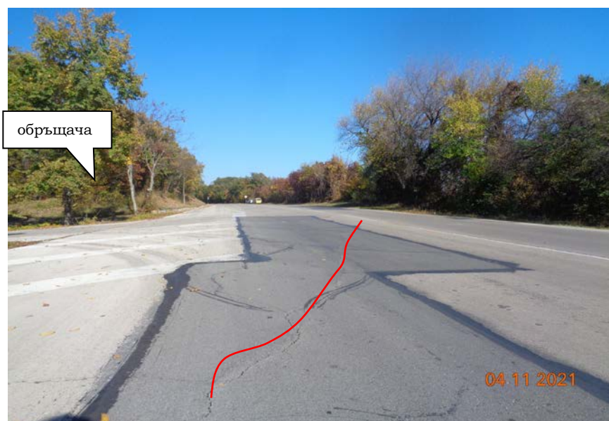
Сн.2. Пукнатини по път I-9
