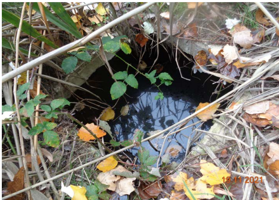
Събирателната шахта , пълна с вода
