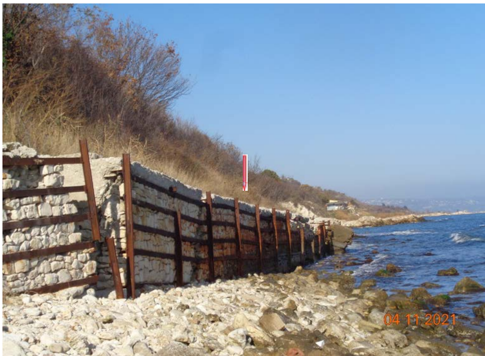
Сн.10. 2021 г. - Брегозащитната стена и откъснат блок от нея
