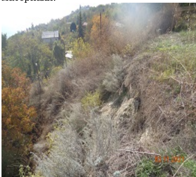
сн.3 - пукнатината-отстъп на свл. „Острия завой“
